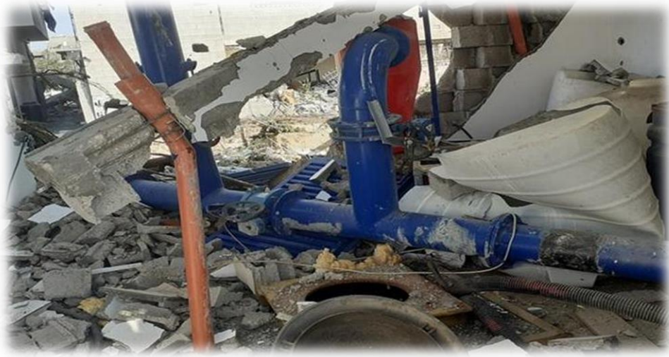
صورة 3 الدمار الذي لحق بشبكات ومحطات ضخ المياه
